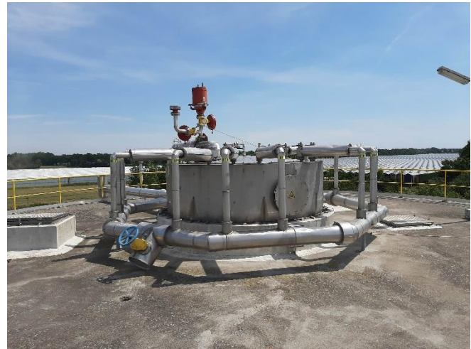
Menginstallatie: gaslansen moeten vervangen worden
